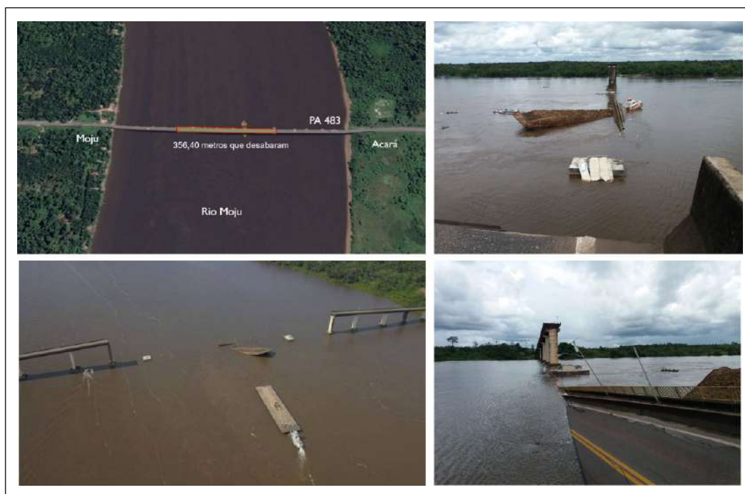
Figura 6. Desabamento de estrutura civil no nordeste do Pará. Fotos: Relatório geral CEDEC (2019).
