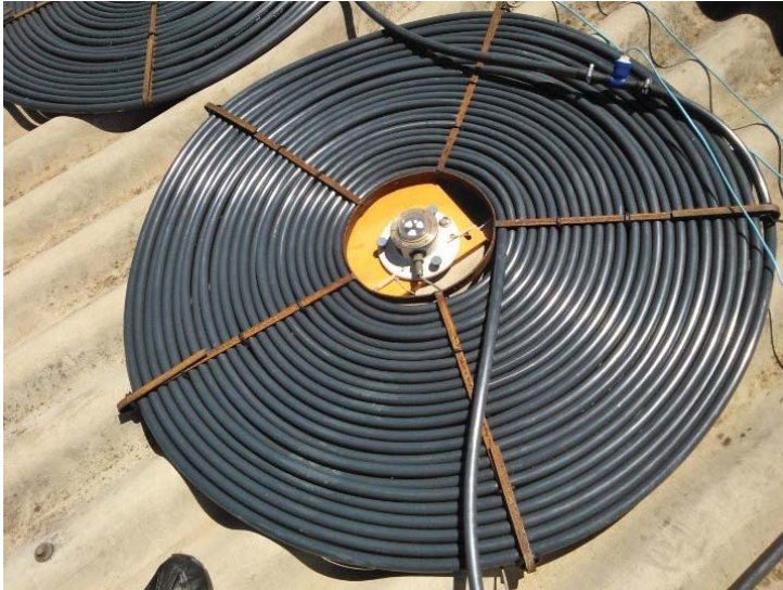
Figura 1 - Coletor Solar de Polietileno.
